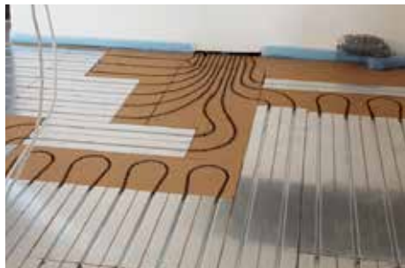
Rohrführung zum Verteiler
